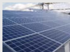
太陽光パネル
