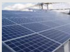
太陽光パネル
