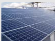
太陽光パネル
