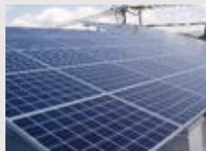
太陽光パネル
