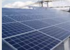
太陽光パネル
