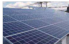
太陽光パネル
